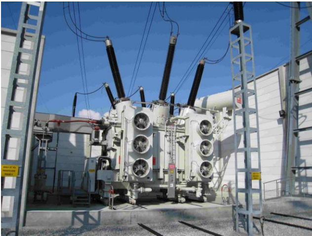
Transformateur HT 385 kV-63kV 600 MVA Poste d'interconnexion d'Albertville
